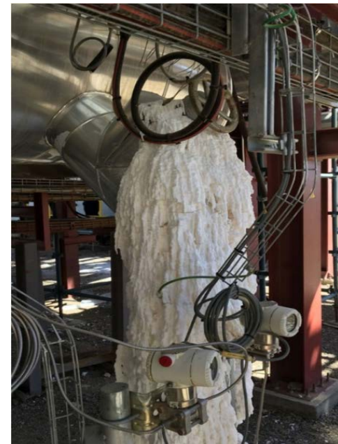
Danneggiamento di una valvola per incontrollata solidificazione dei sali fusi nel piping di un impianto CSP
