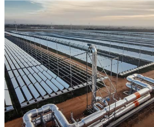
Impianto CSP Fresnel a sali fusi "Sol.In.Par" a Partanna (TP)
