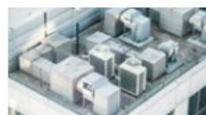
Riscaldamento, ventilazione e raffreddamento (HVAC)
